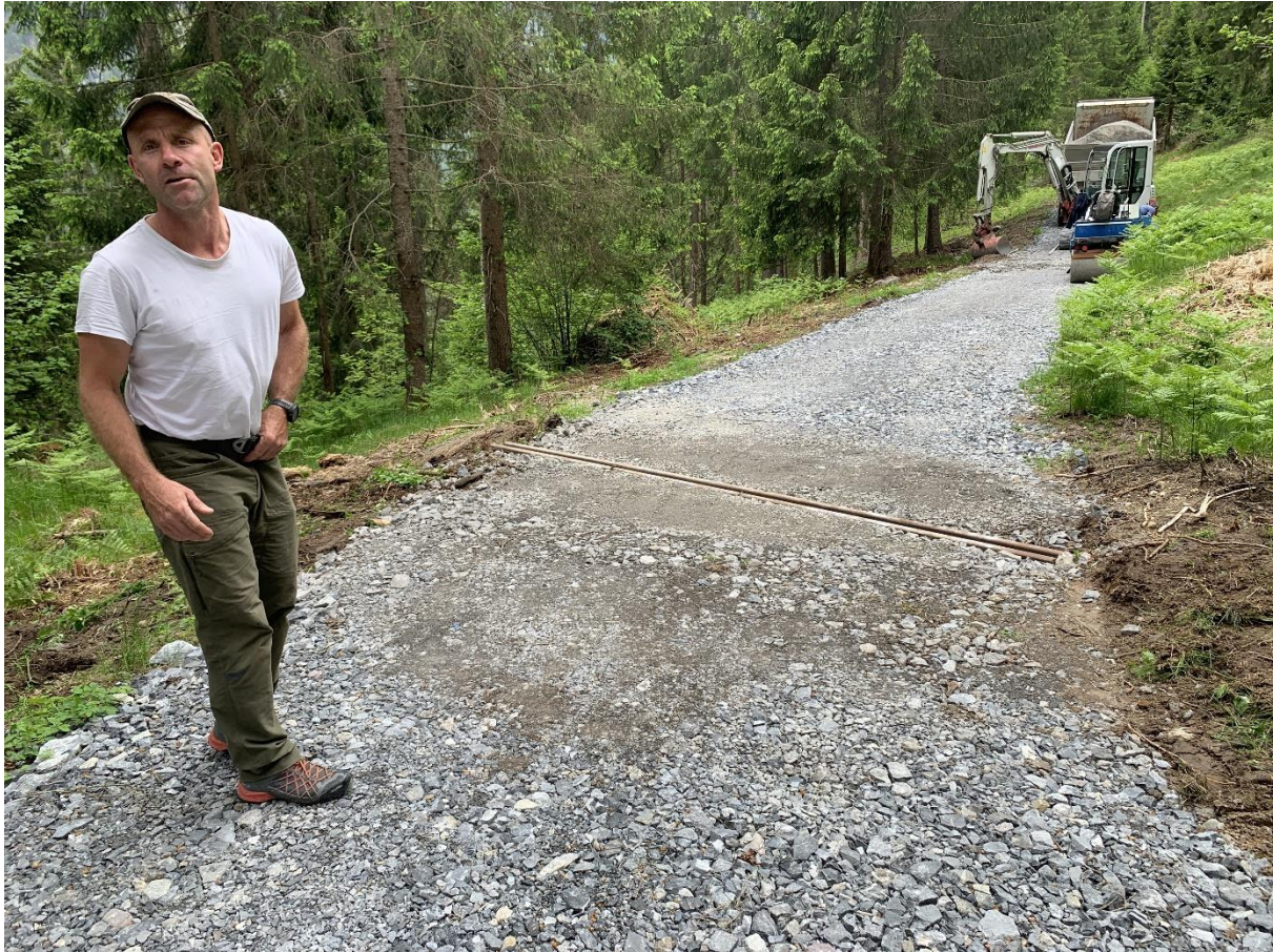
versetzter Querabschlag zur Entwässerung der Fahrbahn die Fahrbahn wurde ohne Verschleisschicht erstellt (Foto: Urs Fliri)
