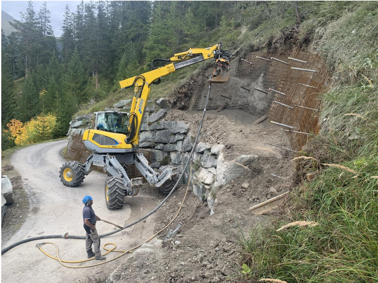
Auftragen des Spritzbetons für die Baugrubensicherung bei Blocksteinmauer Nr. 5, Oktober 2023 (Foto: Urs Fliri)
