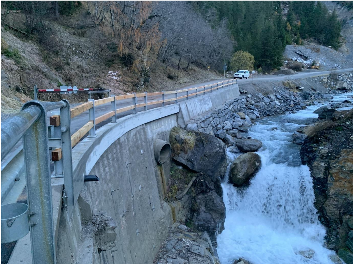
gesicherte talseitige Stützmauer mit Kordon, Uferwehr und Bündnerzaun, November 2023 (Foto: Urs Fliri)
