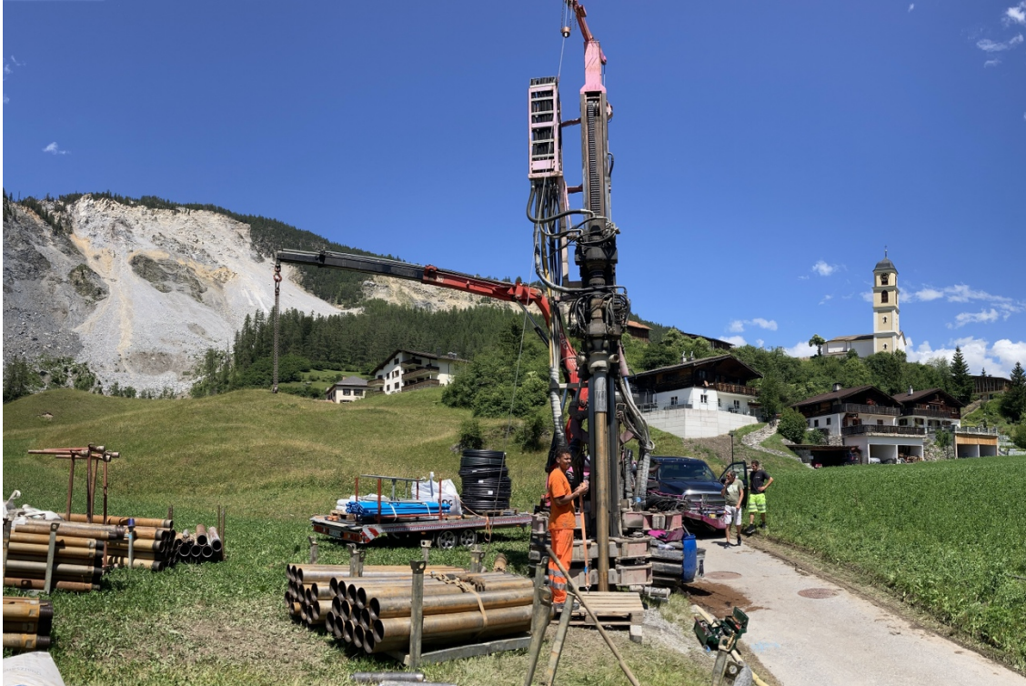
Die «Überwachungsbohrung 4» unterhalb des Dorfes Brien/Brinzauls.
