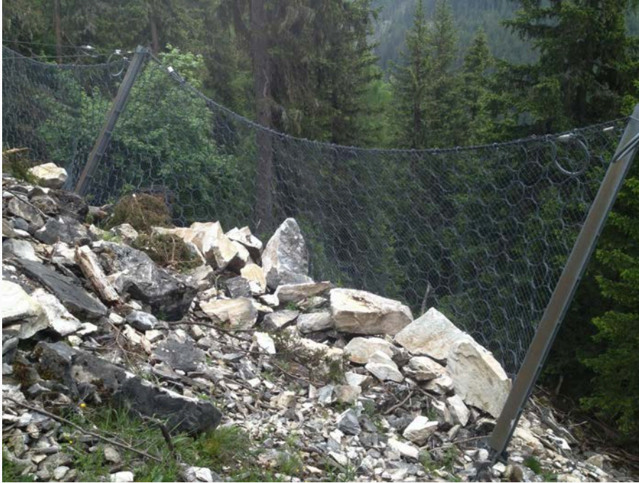
Ein Steinschlag-Schutznetz bei Innerferrara: Abgestürzte Felsblöcke haben es verformt und es hat nicht mehr seine ursprüngliche Höhe.
